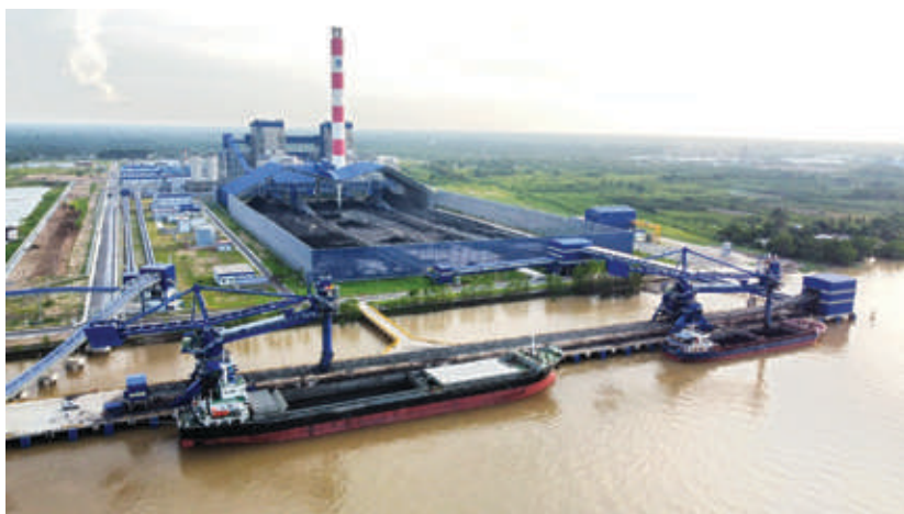
Hệ thống vận chuyển than nhà máy nhiệt điện Sông Hậu 1
