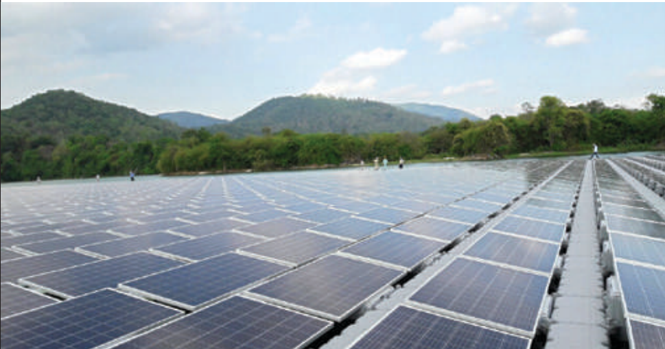
Hệ thống phao nổi nhà máy điện mặt trời
