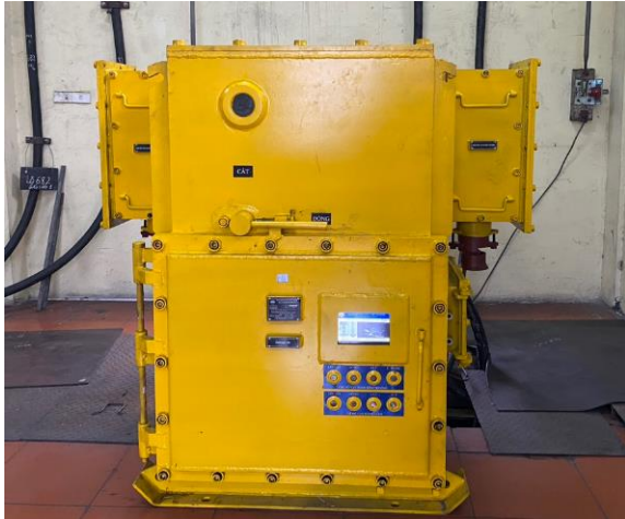
Hình 6: Máy cắt được lắp đặt tại Trạm phân phối 6kV mặt bằng +21 PX Chế biến than
