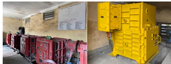
Hình 5: Máy cắt được lắp đặt tại Trạm phân phối 6 kV mặt bằng +27 PX Cơ điện mỏ
