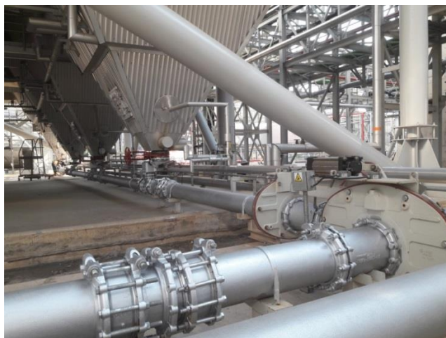
Hình 6. Hệ thống ống dẫn vận chuyển tro tại Nhà máy Nhiệt điện Thái Bình 1 do Narime hợp tác với UCC – Hoa Kỳ cung cấp
