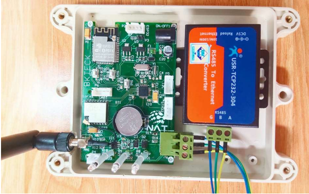
Hình 7. Mạch điều khiển trung tâm hệ thống Home gateway
