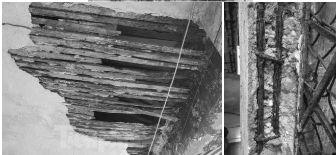
Hình 3. Các loại vật liệu xây dựng (gạch xây, vữa chất, cốt che, bê tông cốt liệu sỏi) ở thế kỉ trước đều có chất lượng thấp nên bị suy giảm chất lượng nhanh
