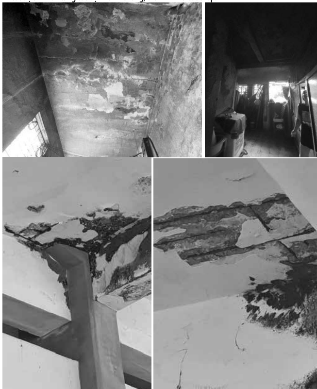
Hình 13. Không chỉ gây khó khăn cho sinh hoạt cuộc sống, thấm đột còn gây ra sự hư hại nghiêm trọng đến hệ kết cấu công trình, đặc biệt là cốt thép
