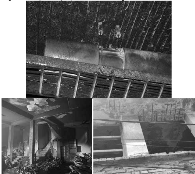
Hình 11. Công trình xảy ra hỏa hoạn dẫn đến suy thoái vật liệu trong khoảng thời gian ngắn
