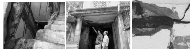
Hình 9. Các công trình tại vùng ven biển và hải đảo có tốc độ ăn mòn cốt thép rất nhanh
