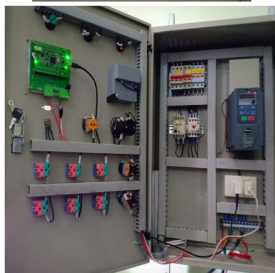
Hình 9. Tủ điều khiển
